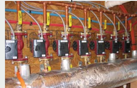
6.4 Mehaanilised ja elektrilised seadmed
